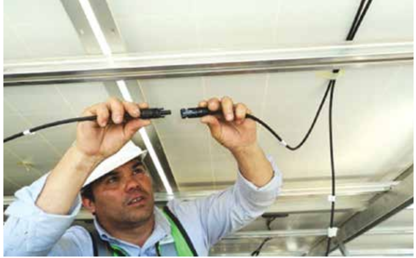
توصيل الألواح الشمسية بالأسلاك الكهربائية
